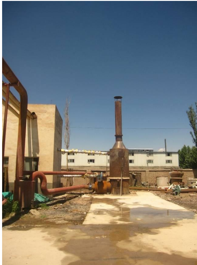
图 4.1-1 已建成的工艺尾气焚烧罐
