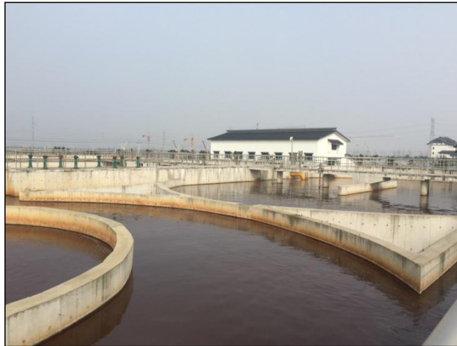
图 3.42 绍兴滨江印染废水处理厂处理设施
