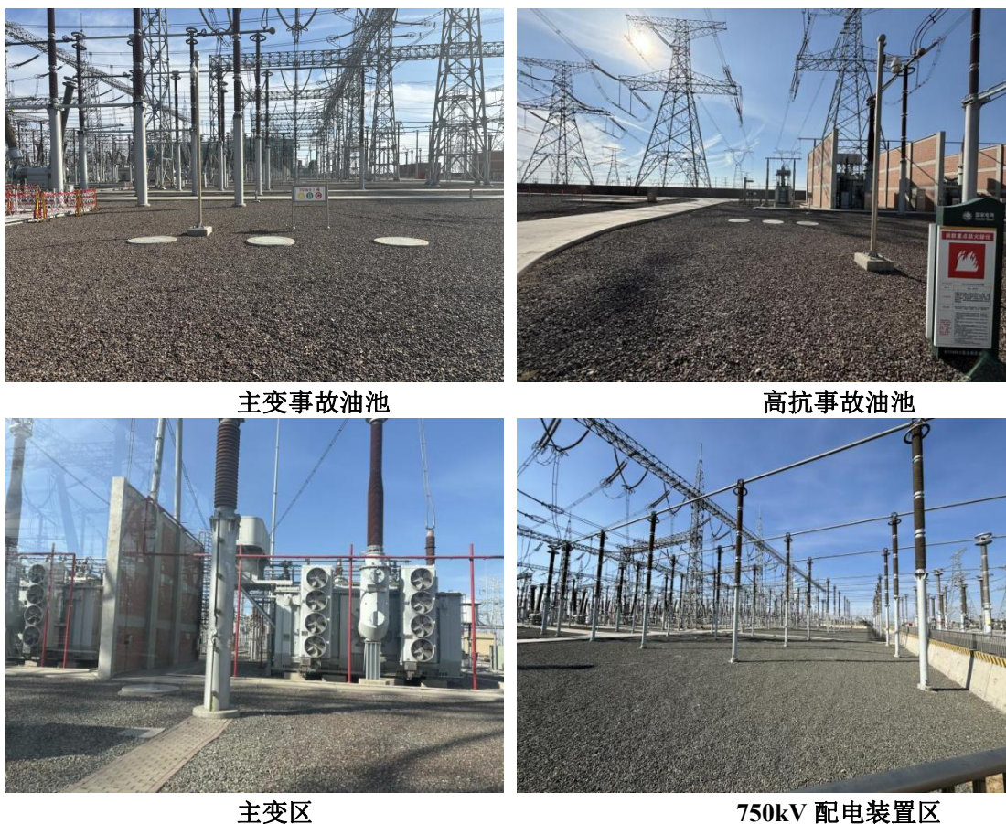
图 3.1-2 五彩湾 750kV 变电站现有环保设施及现场照片
