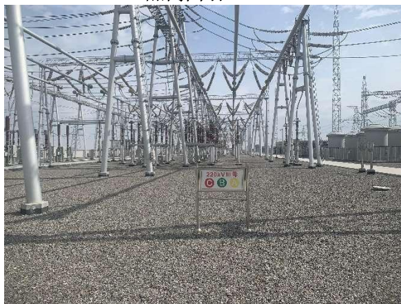
220kV 配电装置
