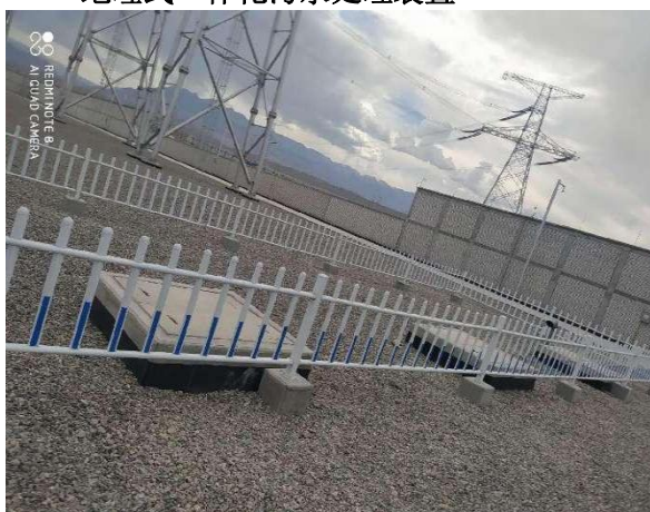
主变事故油池
