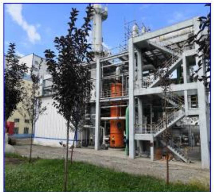
计划改造的变换装置
