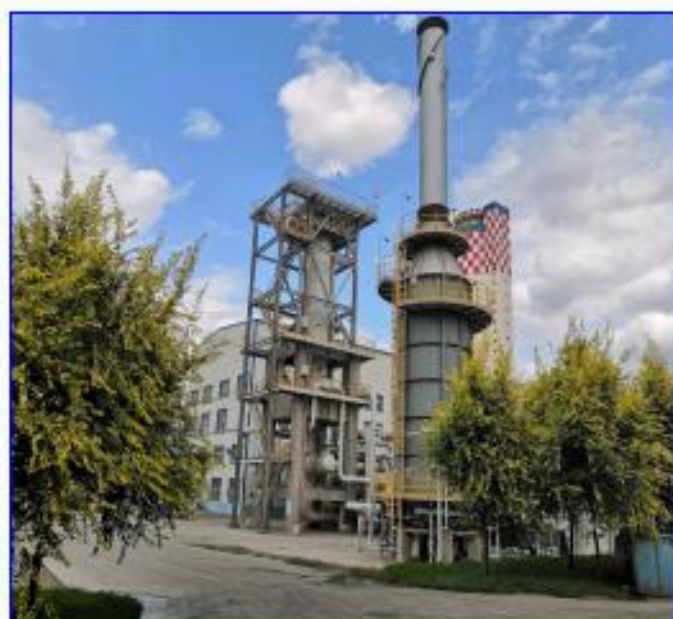
气体净化尾气洗涤塔
