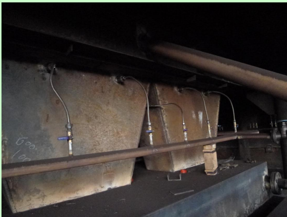
图8-2-3 喷嘴及密闭溜槽
