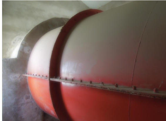
通风井及井口设施
