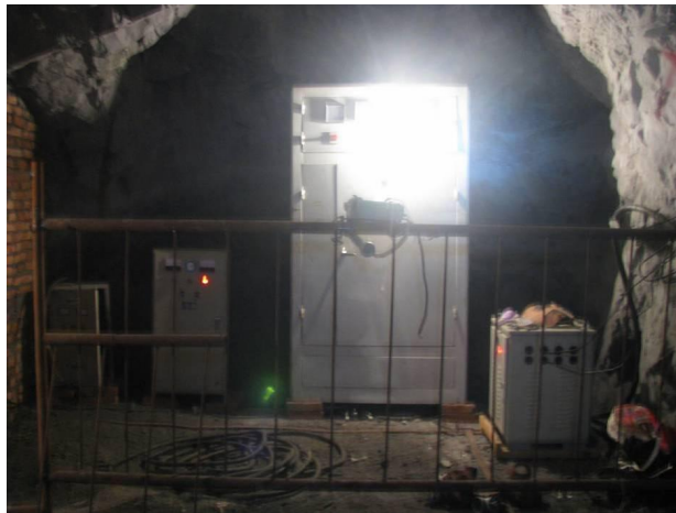
1095m 中段配电硐室
