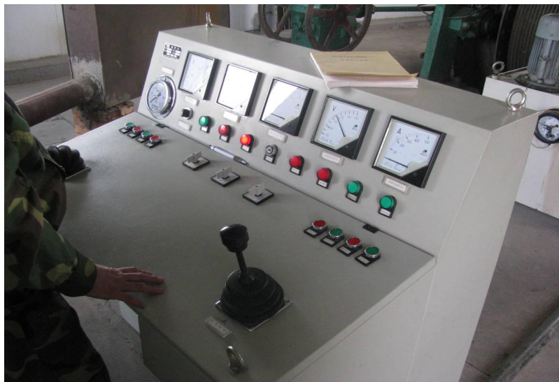
副井提升机操作台
